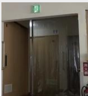
廊下と居室との間への遮煙のためのカーテンの設置例
