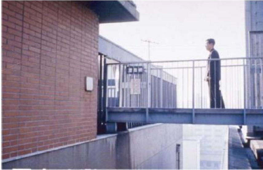
避難橋(固定式)
